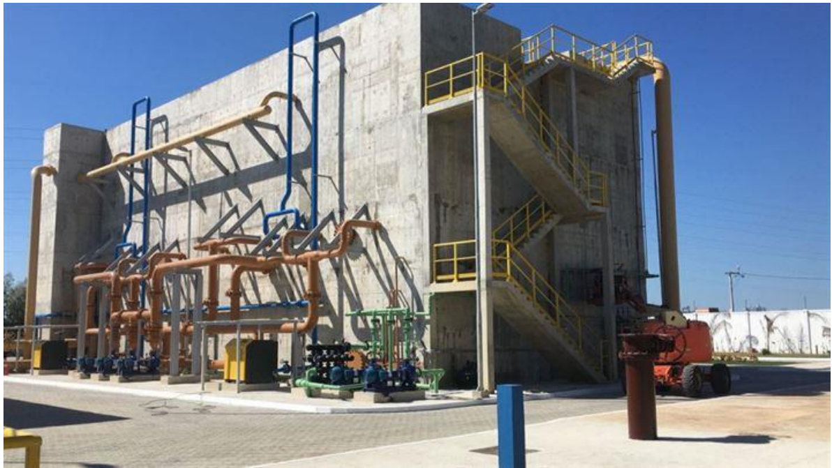
Figura 15: ETE Esplanada, localizada em Campos dos Goytacazes –RJ.
