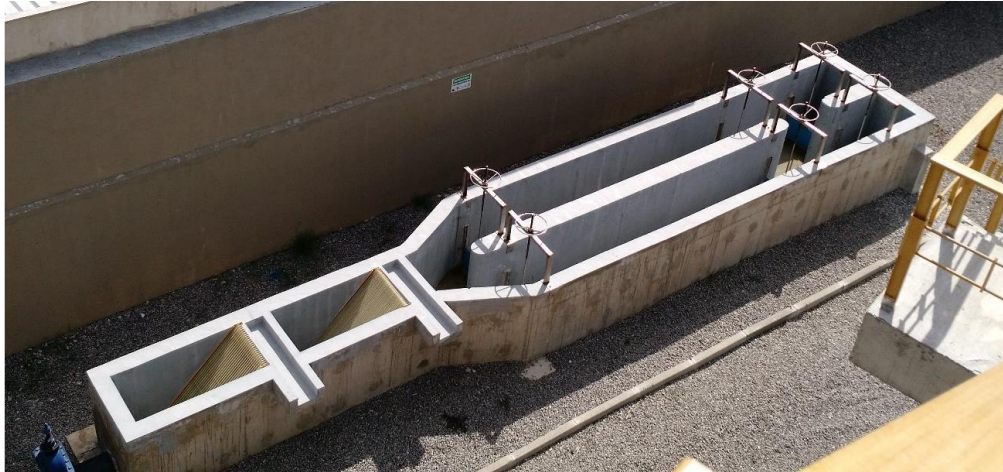
Figura 21: Tratamento preliminar reserva.
