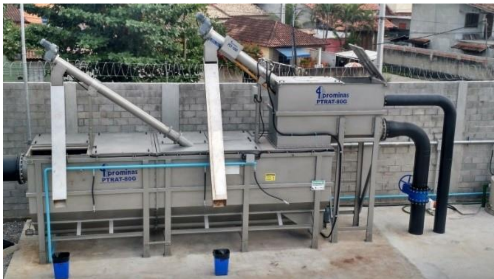
Figura 20: Equipamento de pré-tratamento compacto instalado no local.
