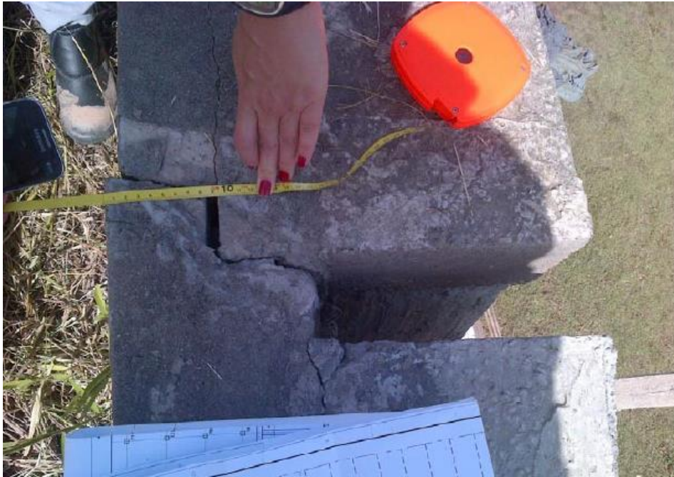
Figura 15 - Visão do deslocamento do topo da cortina.
