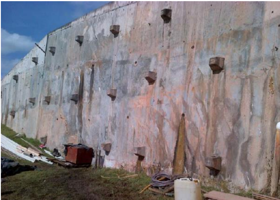
Figura 16 - Trincas estruturais presentes na parede.
