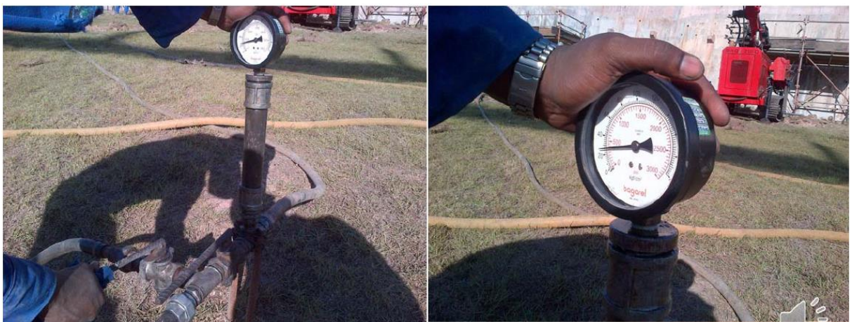
Figura 21 - Manômetro. Instrumento responsável por aferir a pressão de injeção das válvulas manchetes.
