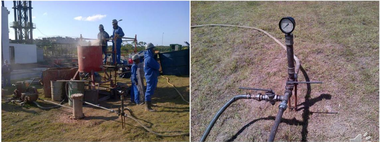
Figura 20 - Central de injeção para o preparo da calda de cimento e sistema de aferição da pressão da calda.
