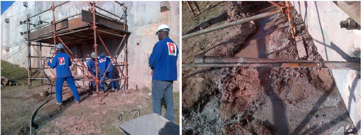
Figura 22 - Hastes de injeção posicionadas para realizar a injeção de fase nas manchetas.
