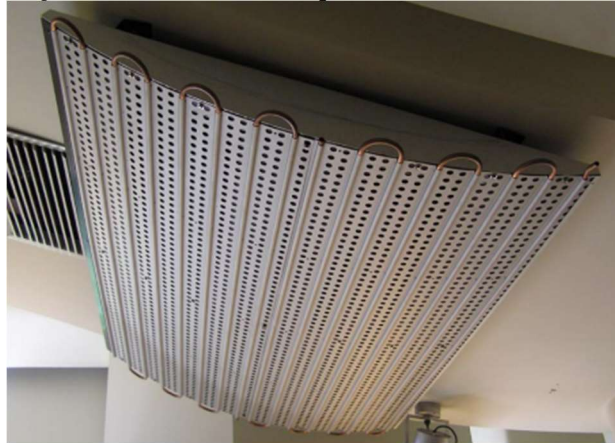
Figura 17 – Painel utilizado para resfriamento das salas.
